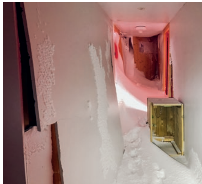
Durch das defekte Dach und die eingedrückte Lukarne drang Schnee in das obere Stockwerk ein.
