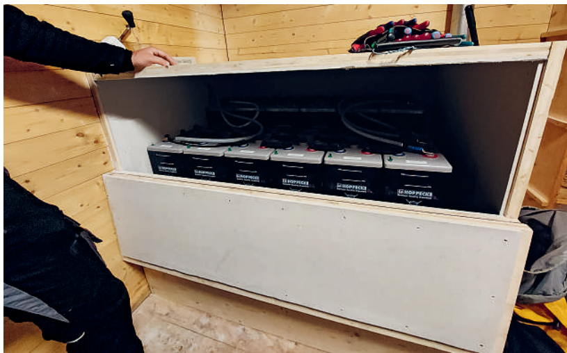
Neue Batterien an neuem Standort.
